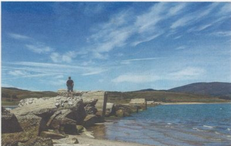
Así se podían ver los restos del fallido puente de Noguero el pasado verano. / ALBERTO RODRIGO
